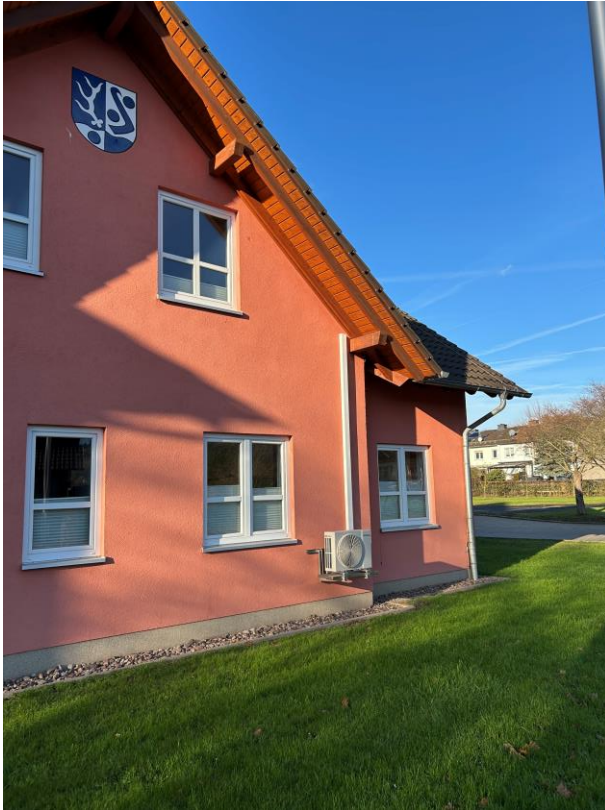
Klimagerät Serverraum Verwaltung Inbetriebnahme 10.11.2025
